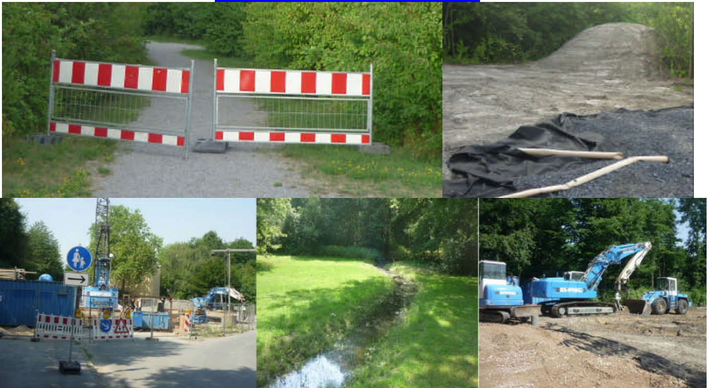
Die baulichen Maßnahmen zur Trockenlegung des Revierparks und Klärung der Abwasserkanäle in der Nähe des Gesundheitsparks zeigen erste Wirkung im Freibad des Parks. Die Liegewiesen sind selbst nach starken Regenfällen nicht mehr so sumpfig und nass wie sonst immer.
